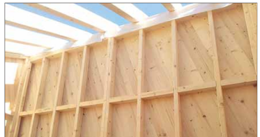
Die „GFM-Platte“ optimiert mit ihrer diagonalen Verlegung die statische Aussteifung von Rahmenkonstruktionen. Fotos: Lennartz (2), Junker (1)
